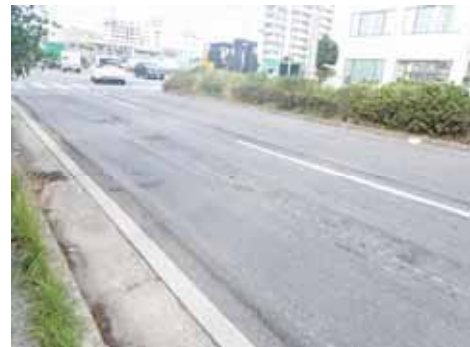
写真-2 臨港道路の損傷状況
