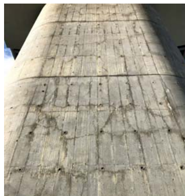
図-4 RC橋脚のひび割れ状況
