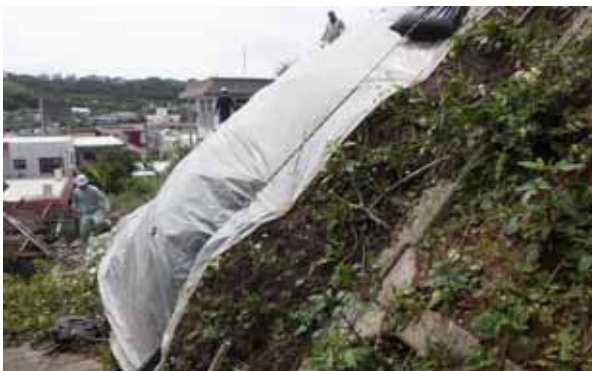
写真-2 法面の変状(はらみ出し)状況
