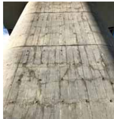
図-4 RC橋脚のひび割れ状況
