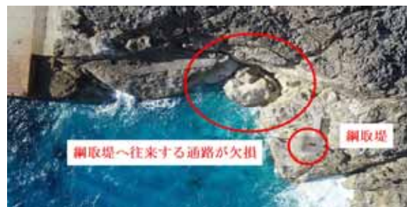
写真-3 被災箇所の現地状況
