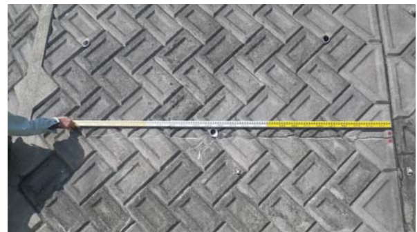
写真.3 法面下方の擁壁亀裂状況
