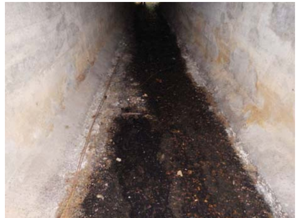
写真-3. 底版の摩耗状況
