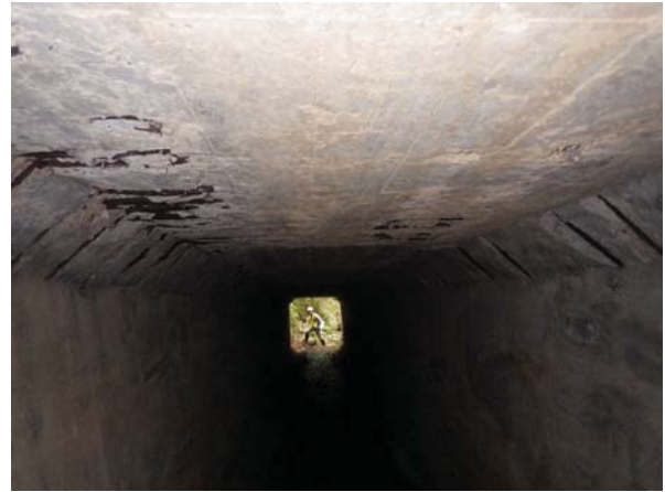
写真-2. 鉄筋露出状況
