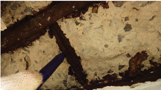
写真-3 頂版下面の鉄筋腐食状況
