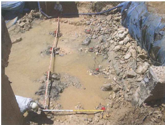
写真-4 コンクリート杭露出状況
