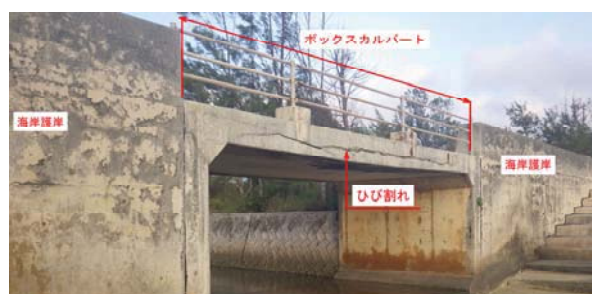
写真-2 対象構造物近景およびひび割れ状況
