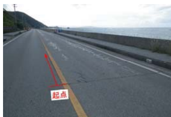
写真-1 起点部におけるひび割れの状況
