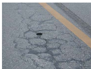
写真-2 中間部におけるひび割れ状況
