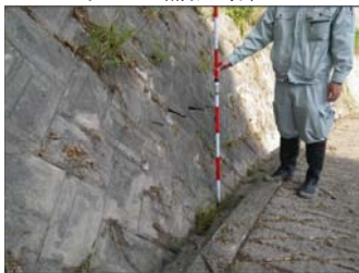
写真-5 Iブロック 間知ブロックに亀裂
