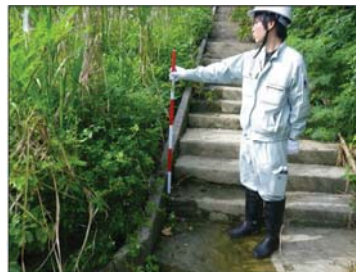
写真-9 階段から湧水
