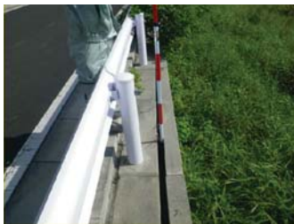
写真-1 Dブロック道路擁壁の変状
