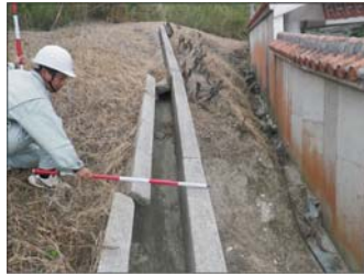
写真-18 排水溝の破壊
