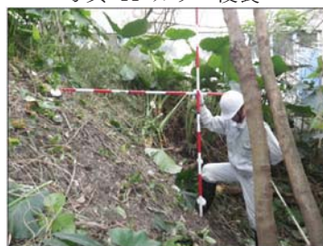
写真-13 道路下の傾斜
