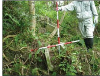
写真-16 U字溝の崩壊
