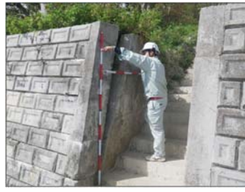
写真-7 間知ブロックの押し出し
