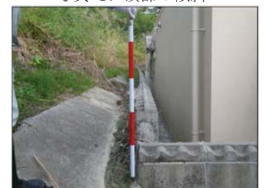
写真-12 擁壁の押し出し
