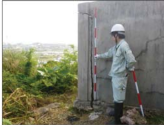
写真-15 擁壁に亀裂
