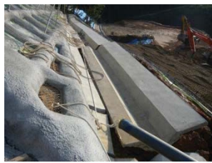
写真-3 法面の崩壊状況(その2)
