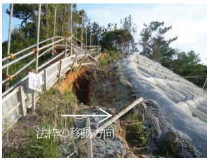
写真-2 法面の崩壊状況(その1)
