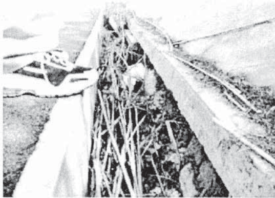
Ph-2 法尻の倒壊し閉塞したU字排水溝
