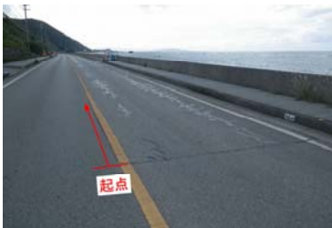
写真-1 起点部におけるひび割れ状況
