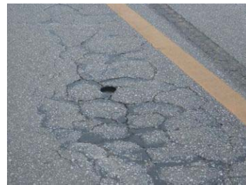
写真-2 中間部におけるひび割れ状況
