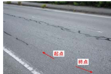
写真-3 終点部におけるひび割れの状況
