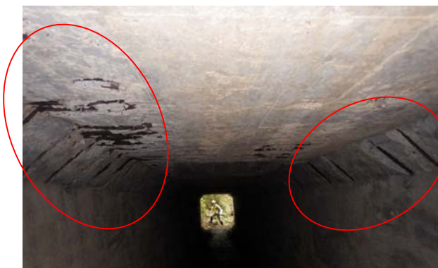
写真-2. 鉄筋露出状況
