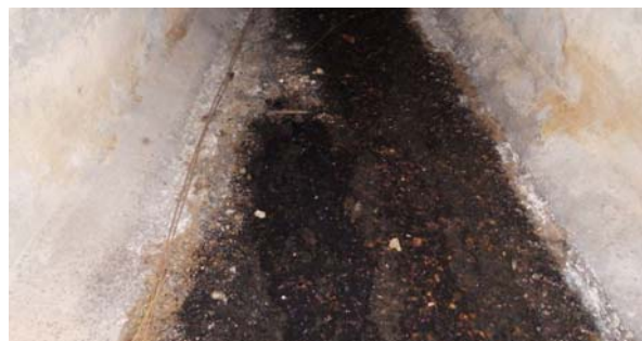
写真-3. 底版の磨耗状況
