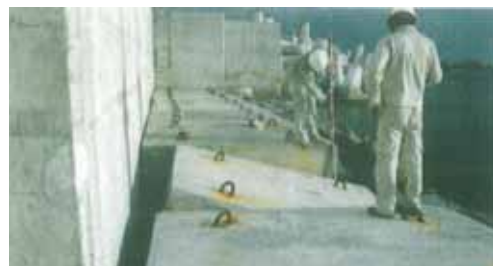
写真 - 4.2 外防波堤の被災断面（その3）
