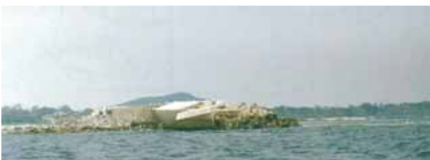
写真 - 2. 外防波堤の被災状況（その1）
