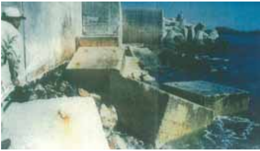
写真 - 4.3 外防波堤の被災断面（その3）
