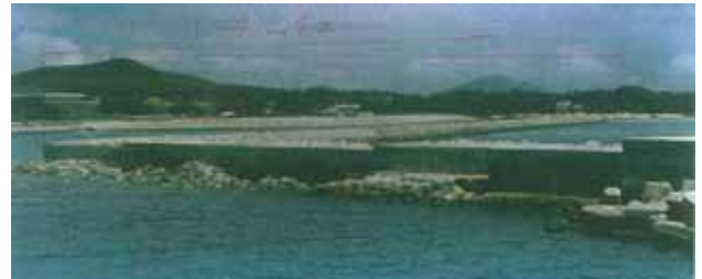
写真 - 3. 外防波堤の被災状況（その2）
