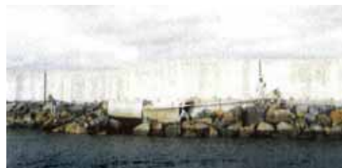
写真 - 4.1 外防波堤の被災断面（その3）
