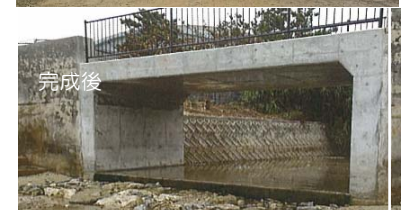
兼城港海岸ボックスカルバート劣化 状況調査業務（南部土木事務所）
